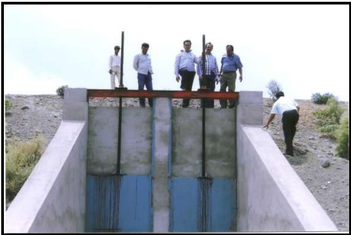
बिहार में नून नदी के तटबंध पर एंटी फ़्लड स्लूइस का निर्माण Construction of Anti Flood Sluice on embankment of river None in Bihar
