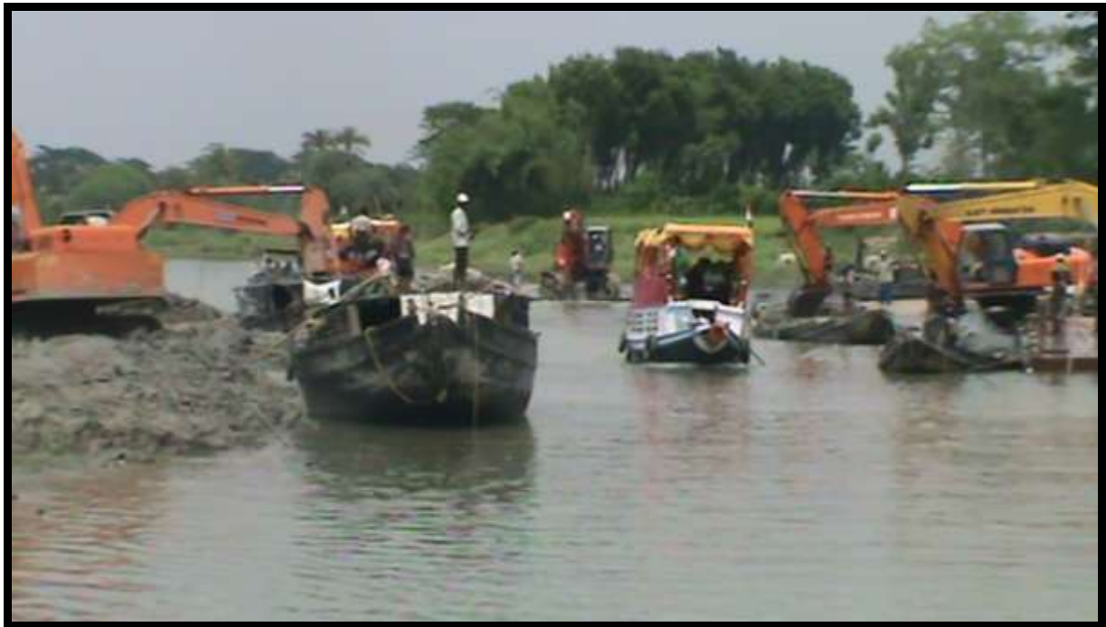
भारत बांग्लादेश सीमा पर इच्छामती नदी के साझा/ सीमावर्ती भाग में गाद हटाने का कार्य Works for Desilting of river Ichamati on common / border stretch on Indo-Bangladesh border in West Bengal
